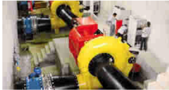
Οικίσκος 2 υδροστρόβιλων τύπου Francis κατασκευής WKV AG.
