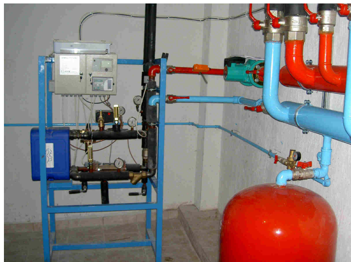
Στη φωτογραφία εμφανίζεται ένας από τους χιλιάδες Θερμικούς Υποσταθμούς Καταναλωτών που έχουν παραδοθεί και εγκατασταθεί στο δίκτυο ΤΗΛΕΘΕΡΜΑΝΣΗΣ ΚΟΖΑΝΗΣ για θέρμανση κτιρίων.
